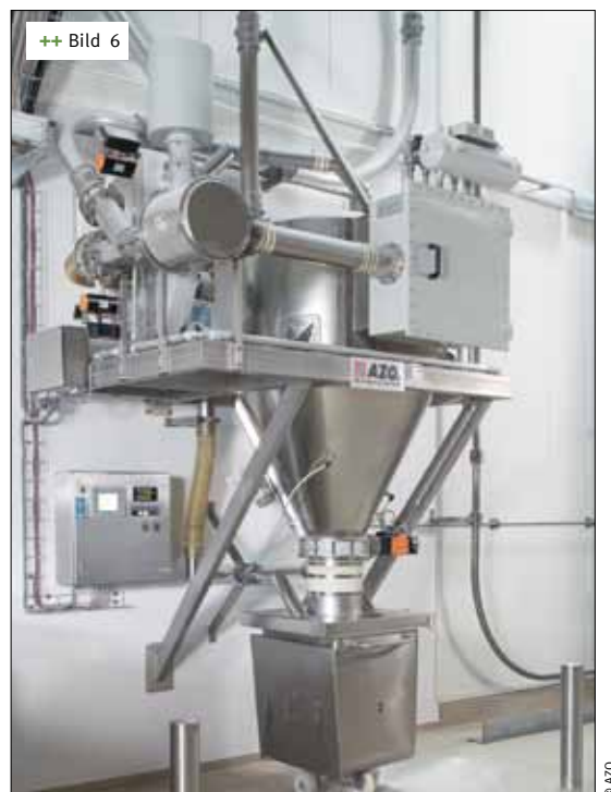
++ Bild 6 Saugwiegesystem mit Förderwaage zur Beschickung der Streumehlanlage
