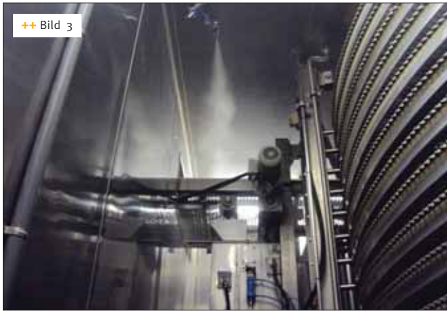
++ Bild 3 Kalt dampfnebel zur Erhöhung der Luftfeuchtigkeit in Gär- und Klimaanlagen
