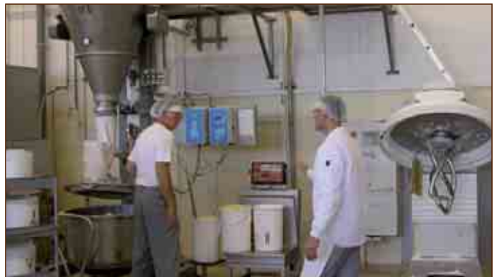
Teigmacherei für die bestehende Linie. Für die Installation der neuen Rademaker-Linie wird sie den Platz räumen müssen.
