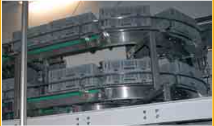
36.000 Körbe fasst das vollautomatische Korblager.
