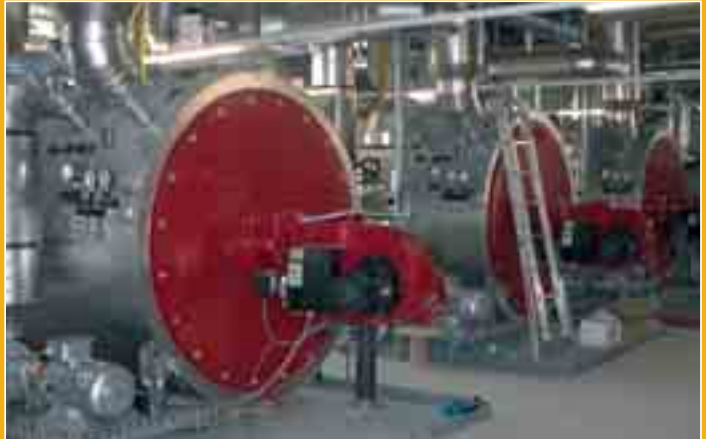
Zwei der drei Kessel reichen aus, die Öfen zu betreiben. Der dritte wird für die Aufheizphase genutzt. Gleichzeitig ist er für Öl- und Gasbetrieb ausgerüstet, um im Notfall den Betrieb aufrecht zu erhalten.
