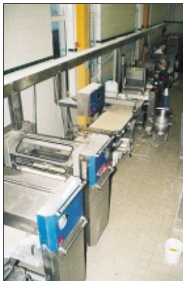
Mit fast 17 m Länge verläuft die Anlage einmal quer durch den gesamten Hallenteil.
