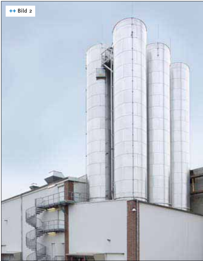
++ Bild 2 Außensilos isoliert mit konstruktivem Explosionsschutz
