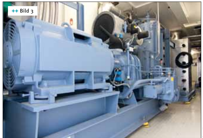
++ Bild 3 GEA Grasso-Flüssigkeitskühlsatz im geräumigen Container
