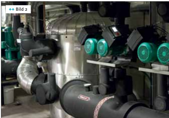
++ Bild 2 Temperweiche im zentralen Maschinenraum
