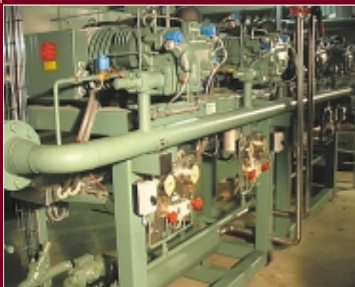
Kompressoren im Keller
