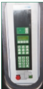
Die Steuerung der Stikkenöfen ist logisch aufgebaut.
