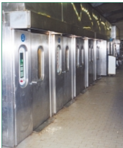
Die fünf Stikkenöfen stehen in einer Reihe direkt neben den Etagenöfen.
