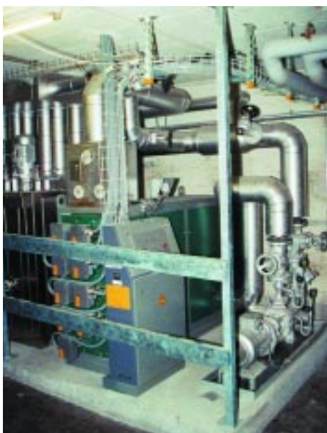
Eine Besonderheit: die elektrisch betriebene Heizzentrale der Thermoölanlage.
