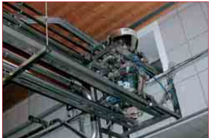
Durch eine Öffnung in der Decke kommt der Vordosiertrichter mit den Klein- und Mittelkomponenten.
